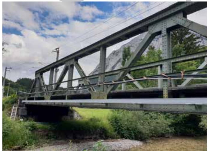
nach der Installation
