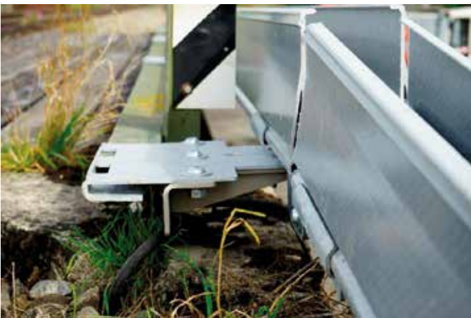
nach der Installation
